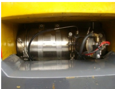
DPF-BU 80 geïnstalleerd in het contragewicht
